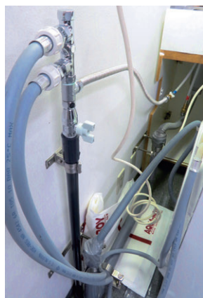
水廻り設備からの漏水 : LH-1、LQ-1
